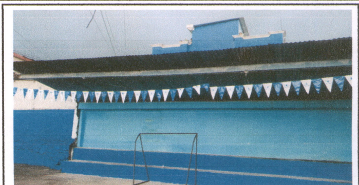
Foto 2: Sustrucción de lámina, por lámina troquelada aluzinc calibre 26, sustrucción de estructura de soporte de metal por metal
